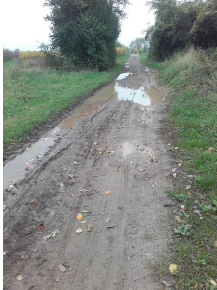
Dieser Wirtschaftsweg entlang der B38 ist als Radweg ungeeignet.
