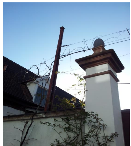
Oberleitungsposten in Roth (6)
